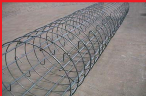
Tubulão produzido com solda MIG manual em instalações do 'Belgo Pronto' (vergalhão utilizado: barras endireitadas a partir de Belgo 50 soldável produzido em rolo)
